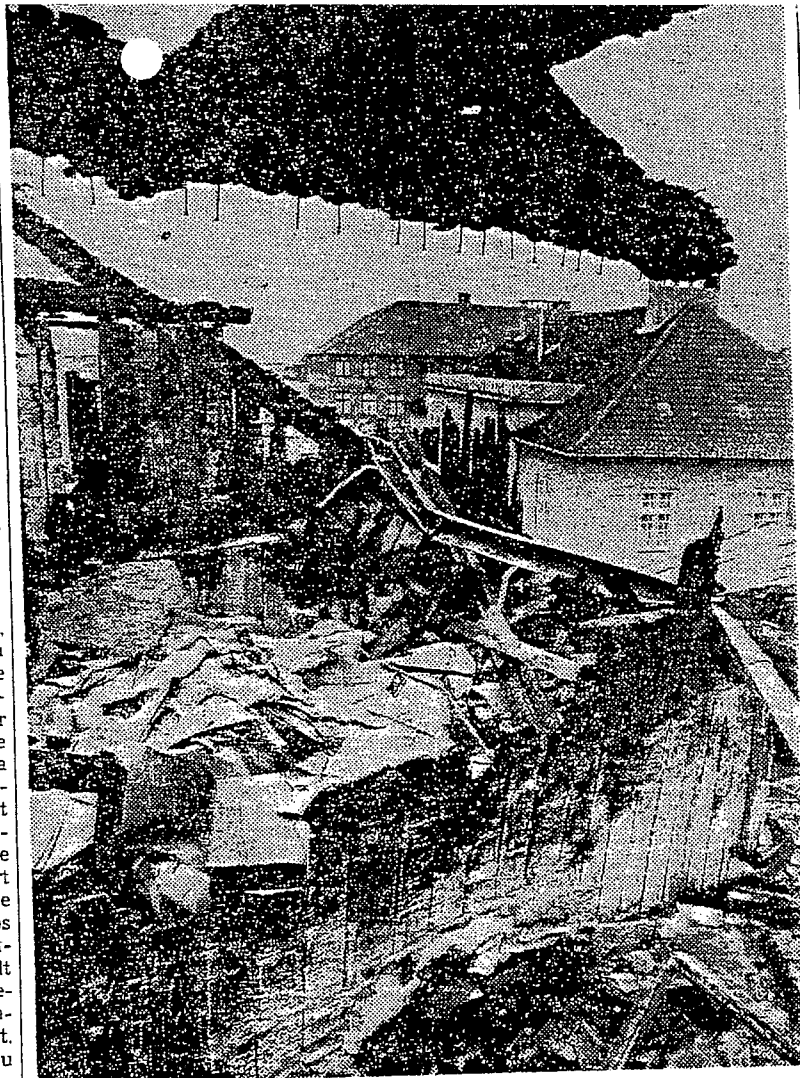
— Hvorfor kan taget ikke overdækkes af en presenning, siger de forretningsdrivende, der dag for dag ser vandet sive længere og længere ned gennem bygningen. I baggrunden det gamle Nørresundby rådhus
